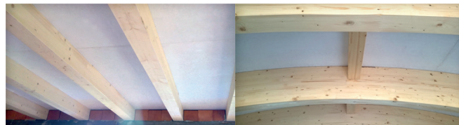
Foto 1: Střešní konstrukce – Desky OSB Firestop jako podhledová vrstva, spáry přetmeleny Firestop basic tmelem. Obrázek je před aplikací interiérového nátěru.
